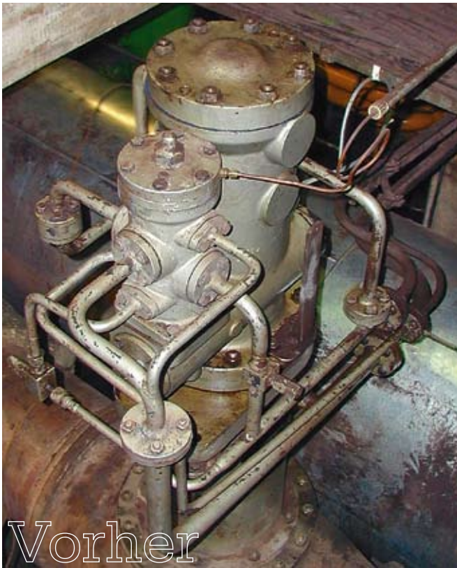
Alte Konstruktion: Mechanische Vorsteuerung und aufwändige Verrohrung.
